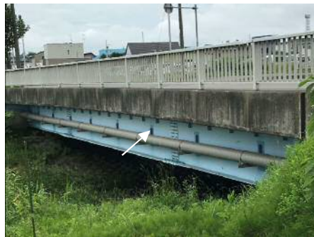
図-3.3.2 橋梁添架管（柏橋）
