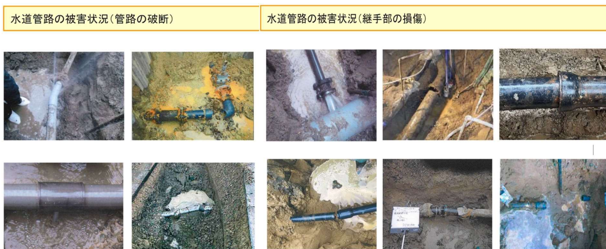
第2回上下水道地震対策検討委員会（2024/5/10） 資料3-1 上下水道施設の被害状況について（抜粋）
